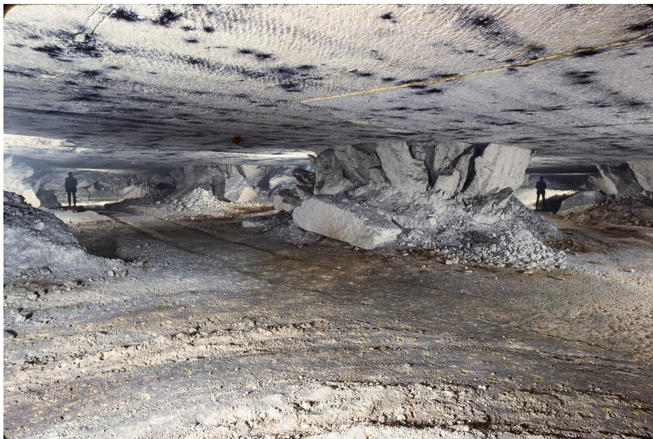
FIG. 4. — Vue de la carrière souterraine de Chancelade effondrée à la suite d'un coup de toit. L'écrasement identique de tous les piliers sous un ciel de carrière intact est caractéristique du synchronisme de ce phénomène. Crédit photo : B. Souffaché.
